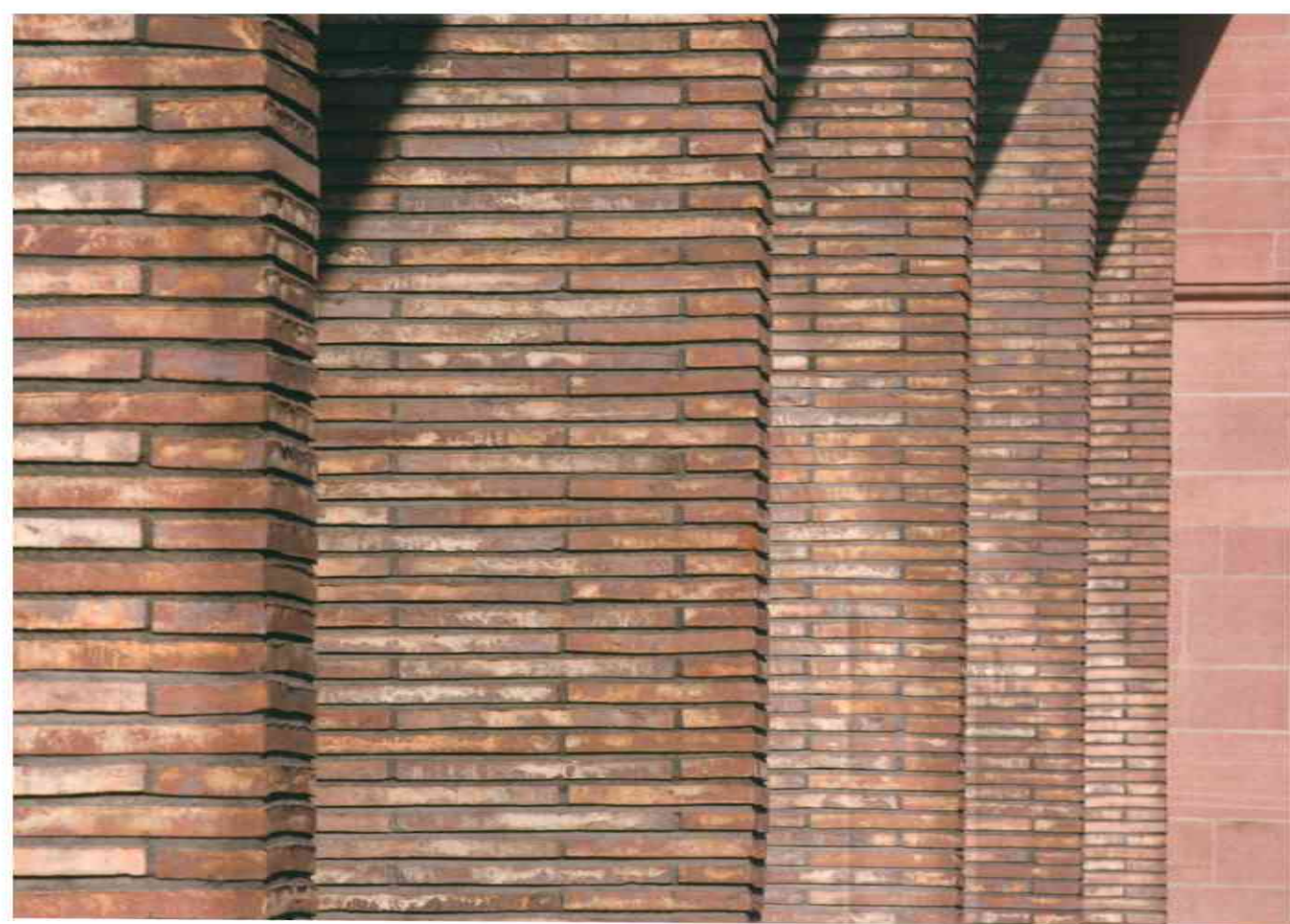
Die Architekten entschieden sich dafür, die neuen Gebäude mit handgefertigten Steinen zu verkleiden, deren Nuancen in Rot, Grau, Braun und Golden sich in der 107 Jahre alten Sandsteinfassade des Bahnhofs wiederfinden.
